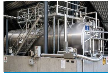
Flue Gas Desulphurisation
