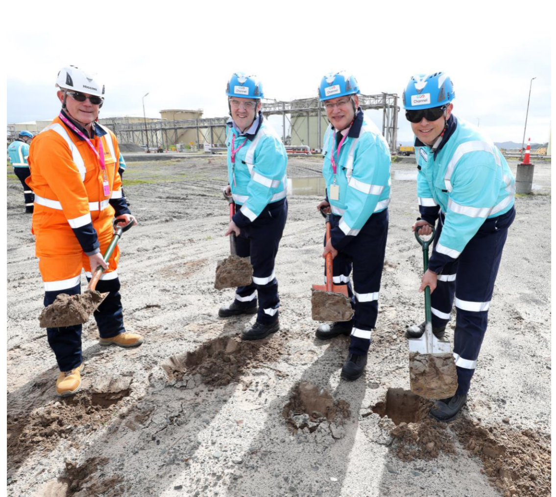
Bitumen Import Terminal
